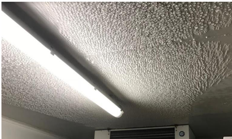
7.50. ábra. A hűtőkamra mennyezetének jegesedése
